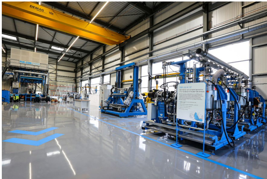
Bessere Ausnutzung und kürzere Wege innerhalb der rund 1000 Quadratmeter großen Halle. Im Vordergrund: 6-Komponenten-Hochdruckdosiermaschine mit 40-t-Formenträger.
